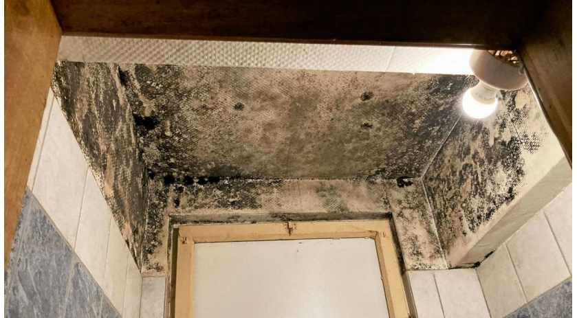
Verschimmelte Wohnungen der Leiharbeiter*innen
